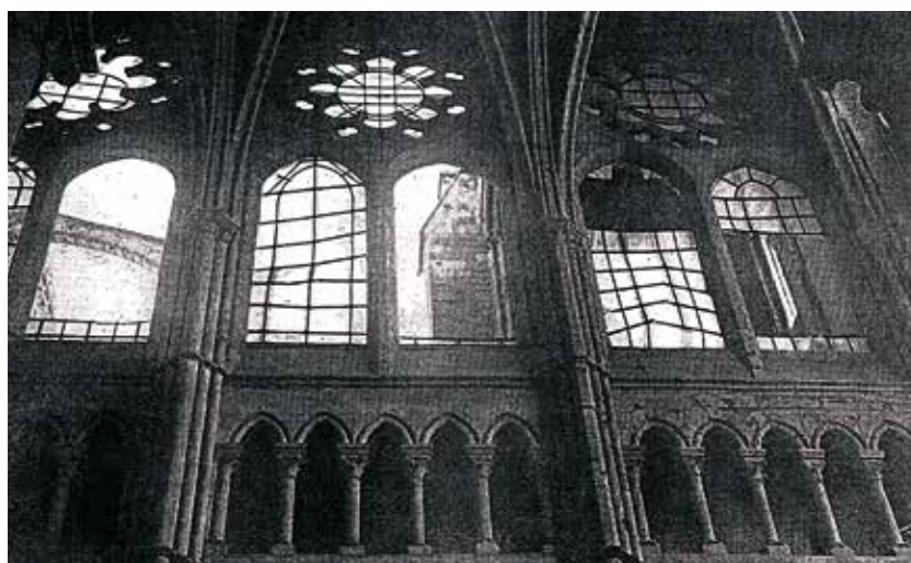
État des baies provisoires en Vitrex après le bombardement de l'aérodrome.
